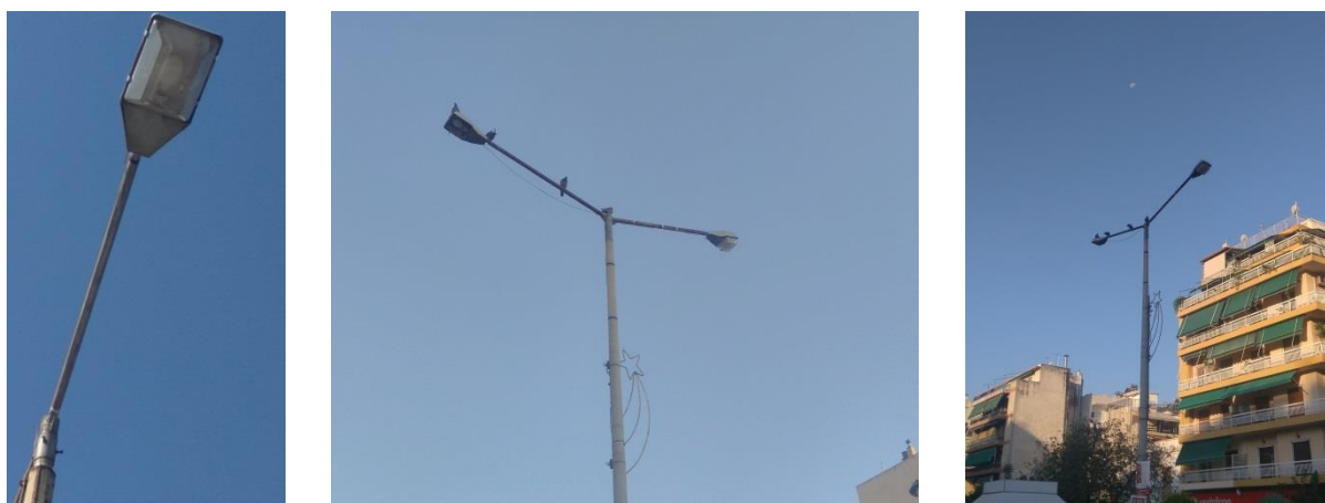
Εικόνες υφιστάμενων τοποθετημένων φωτιστικών σε λεωφόρους, πριν την παρέμβαση
