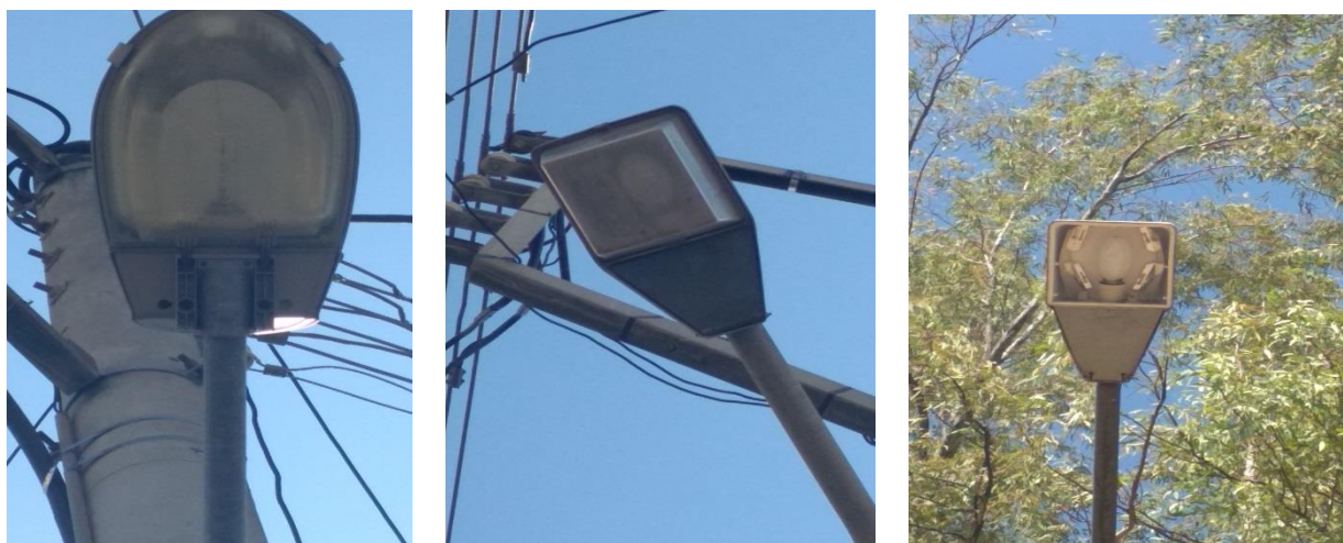
Εικόνες υφιστάμενων τοποθετημένων φωτιστικών σε οδούς, πριν την παρέμβαση.
